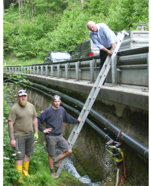
Vzbgm Strohmayer freut sich über den Baufortschritt bei der Glasfaserverlegung Weißenbach und dankt den Mitarbeitern der Firma Wurzer.
