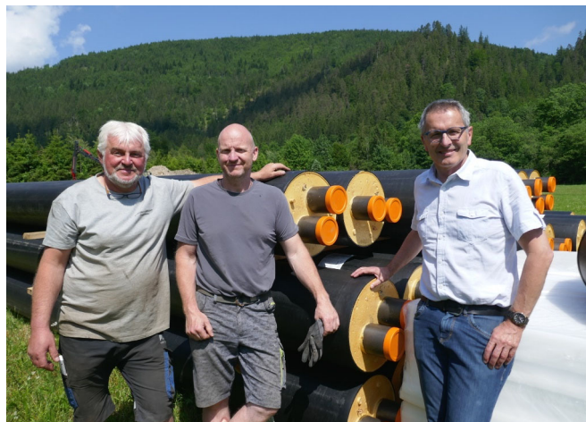
Der Obmann der NWG-Nahwärmeversorgung Lunz Karl Pechhacker und sein Stellvertreter Norbert Heigl bei der Baubesprechung mit Bgm. Josef Schachner.
